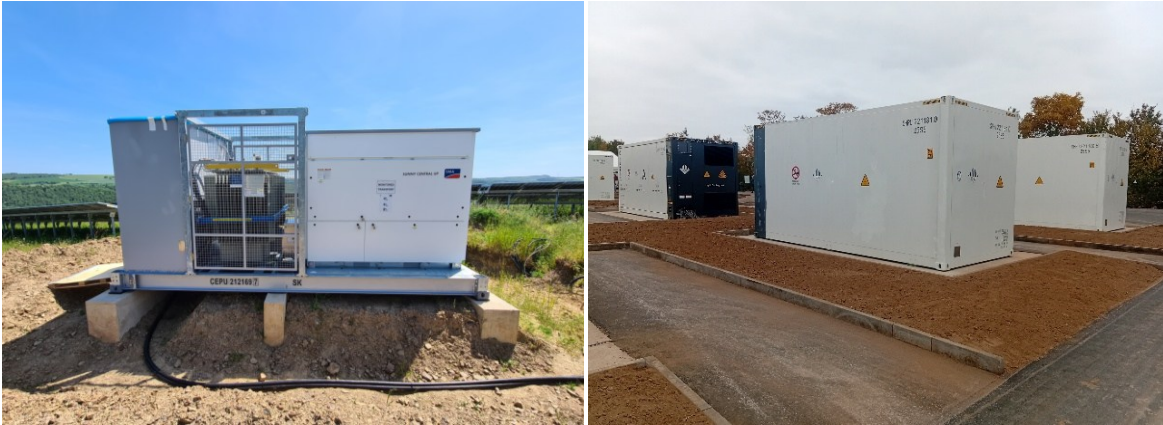
Abb. 2 Kombistation (Trafo, Zentralwechselrichter und Schaltanlage) auf Streifenfundamenten (links) und Batteriespeicher (rechts).
