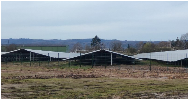
Abb. 2 Süd-Ansicht einer Ost-West-Anlage mit geringen Reihenabständen
